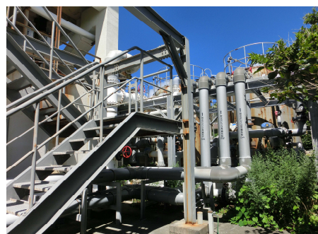
海水取水施設
