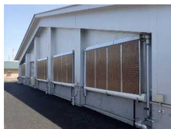
クーリングパッド (舎内冷却用)
