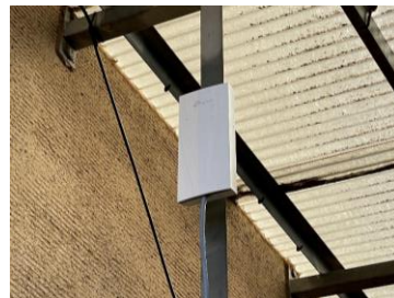
母屋軒下等の柱に設置
