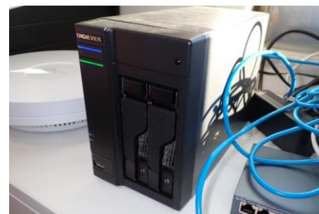
カメラサーバー
