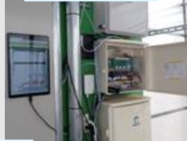
環境制御装置
