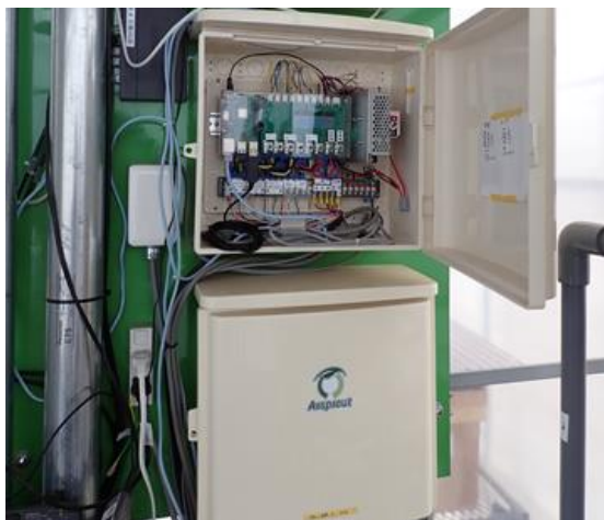
環境制御装置
