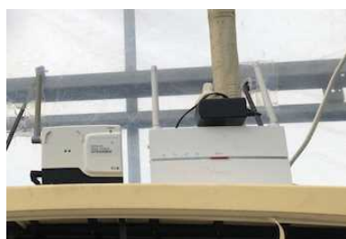
親機の設置状況
