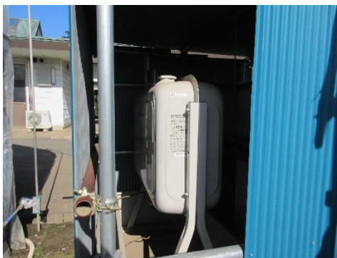
写真6 灯油タンク⑳224リットル
