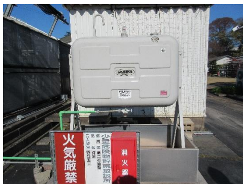
写真5 灯油タンク⑰405リットル
