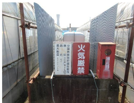
写真4 灯油タンク⑪468リットル
