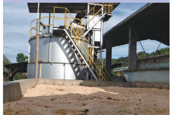
↑ 堆肥化装置と脱臭槽（手前）
