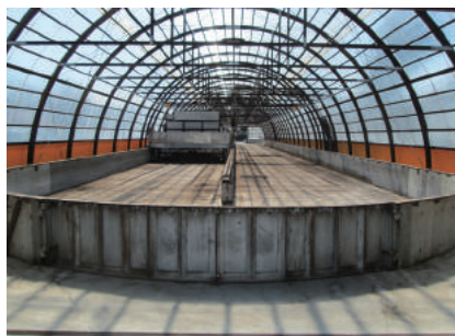
↑ 横型ロータリー式醗酵槽
