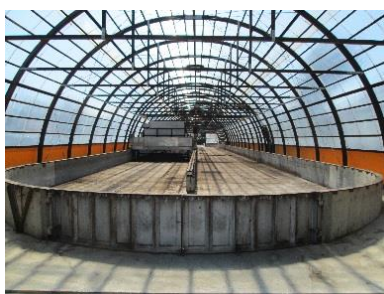
横型ロータリー式発酵槽
