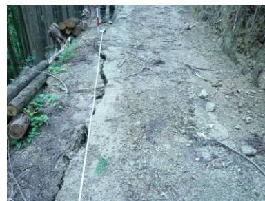
図7 路肩クラックと路面沈下
