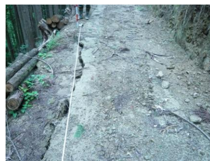
図2 路肩クラックと路面沈下
