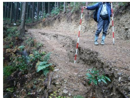
図3 路体の崩落被害
