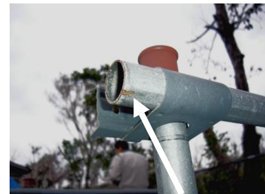
図6 横パイプ管端接合部に発生した赤錆 (阿古 無被覆区 ZA)
