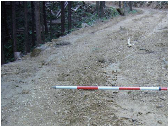
1 作業道の雨水による表土流出状況
