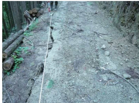
4 路肩クラック
