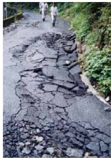
写真 - 3 2001年9月10日の台風第15号による奥多摩の林道の被害
