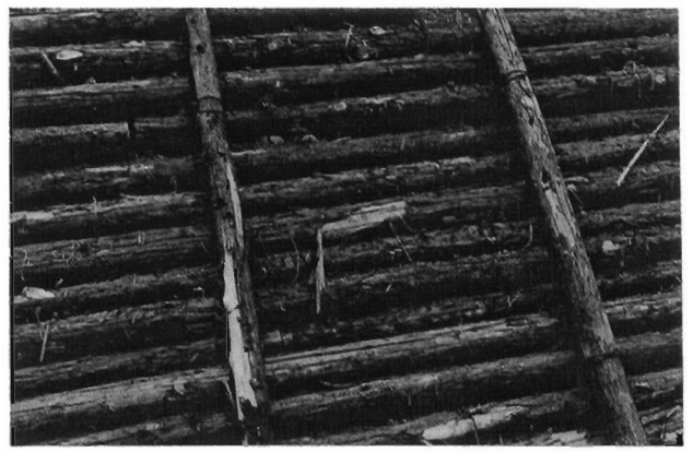
写真-2 スギ間伐材による法面保護工 (1995年 当日の出試験林内)
