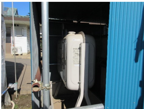
写真6 灯油タンク⑳224 ℓ
