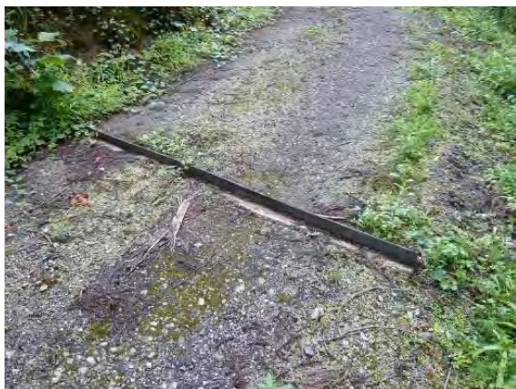
写真-19 ゴムベルトを使用した横断溝
