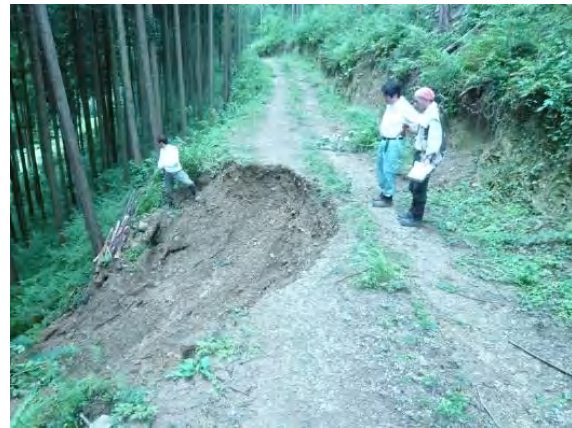
写真－６ 同一勾配の直線部では、雨水の滞留による路体崩落に注意が必要
