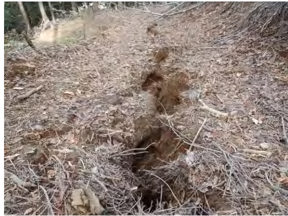
写真-28 路面洗掘が拡大し、通行が困難な状態上部での水切り措置が必須
