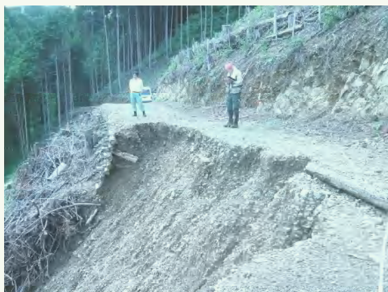
写真－3 路側崩落 16箇所確認
