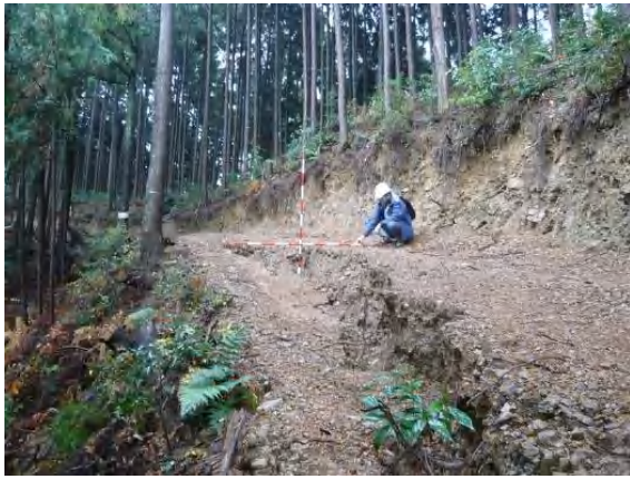
写真-31 路体が崩落し通行困難な状態
