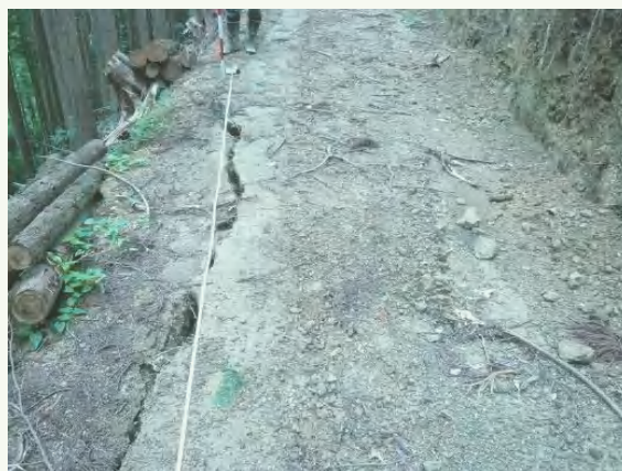
写真－4 路体のクラック 6箇所確認 放置すると路側崩落へ発展する危険性が高い
