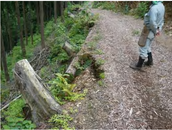
写真-27 路肩の小崩落
