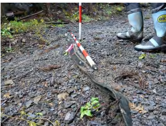
写真-29 横断溝の山側に堆積した土砂排水機能を保つためには土砂の除去が必要
