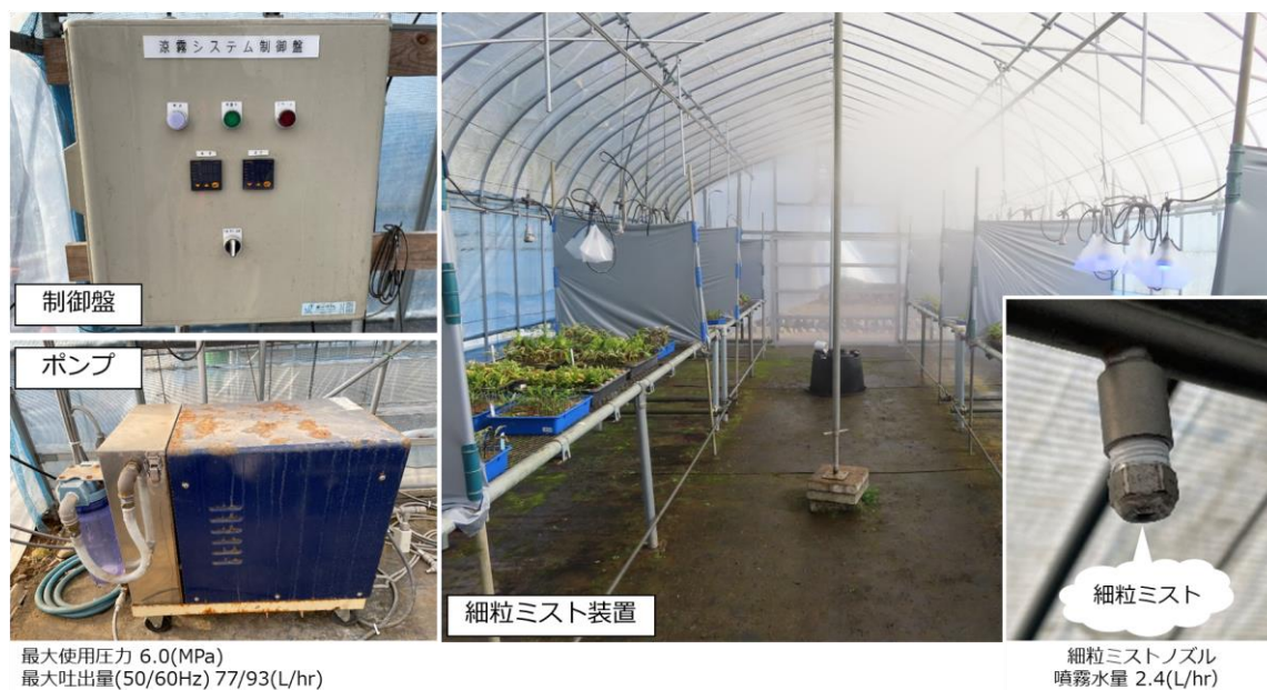
写真3 涼霧システム
